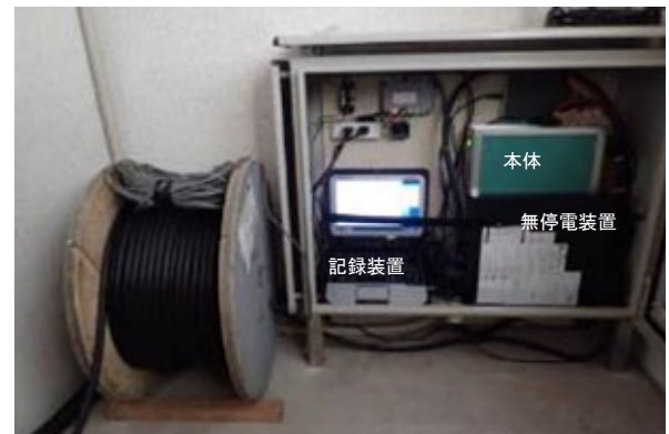
図4 検出器，記録装置の設置状況（衣浦港潮位観測所内）
