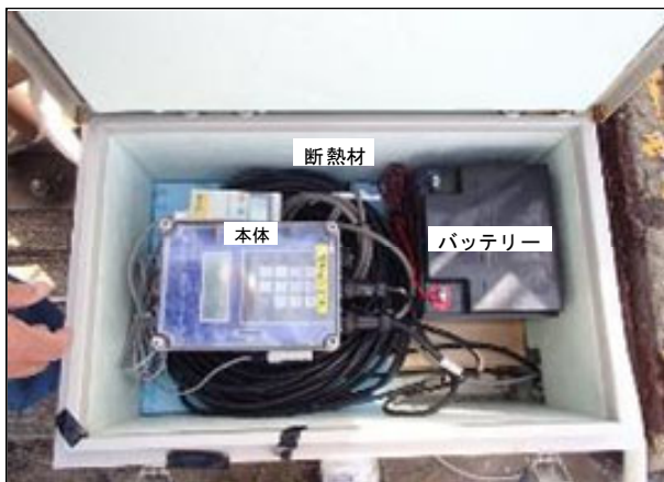
図 9 水圧式計測機器の機器本体、電源装置の設置状況
